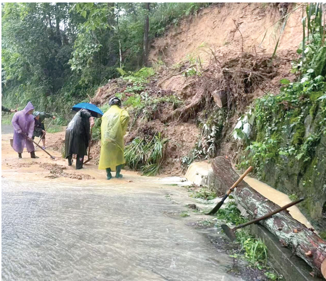
19日,张家界市永定区谢家垭乡村干部处理山体滑坡。图/张家界永定区工作人员提供
